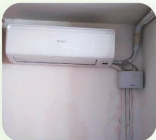
鏽蝕漏水嚴重的老舊冷氣 企需汰換
